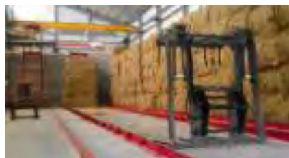
Fourche pour balles de paille en chaufferie
